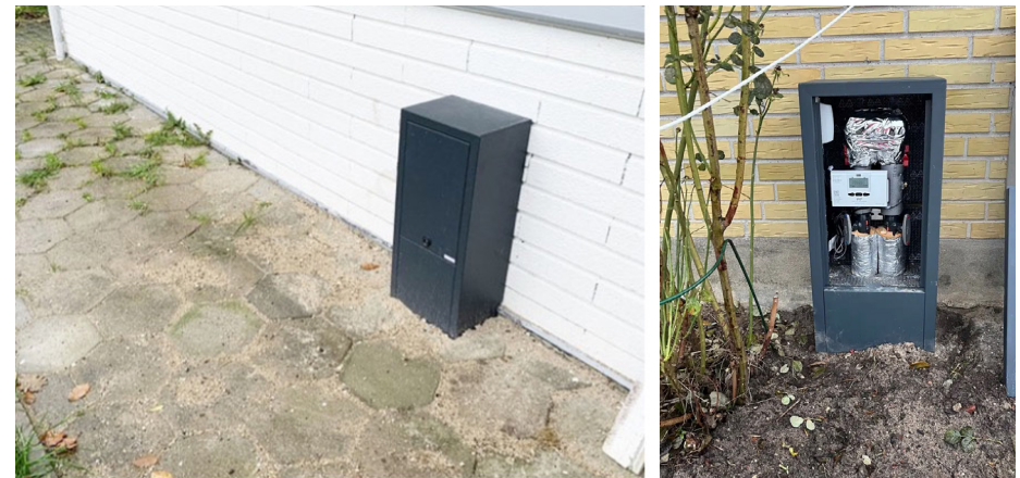
Figuur 4 – Aansluiting op het warmtenet aan de buitenzijde van de woning (Greve Fjernvarme, z.d.; Naested Fjernvarme, z.d.)
